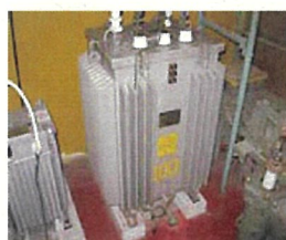
変圧器 (トランス)
